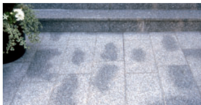
Vlhkost nahromaděná v betonu vede neodvratně ke vzniku vlhkých skvrn.
