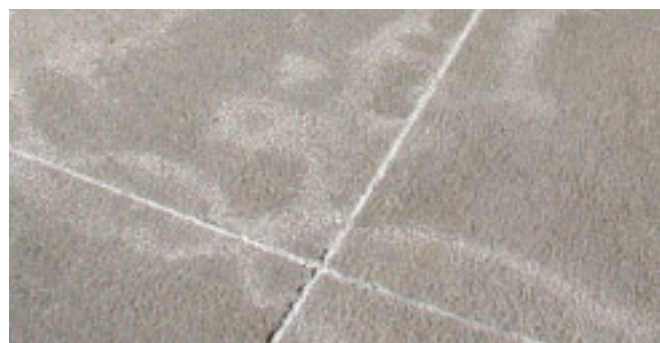
Dlažba v exteriéru není vodotěsná a vlhkost unikající z konstrukce způsobuje výkvěty – ty pak vyžadují kompletní sanaci.
